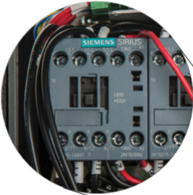
SIEMENS besturingssysteem / SIEMENS relais
